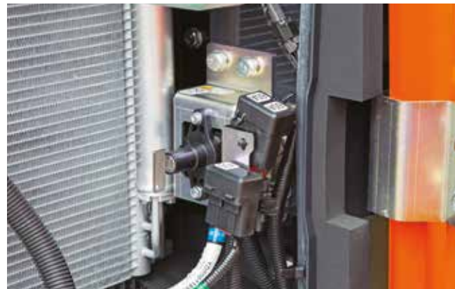
Odpojovací spínač akumulátoru umožňuje bezpečnou údržbu.
